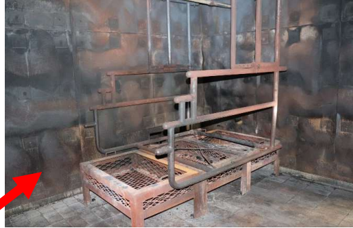
1 階南中央燃焼室
