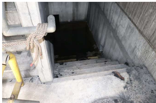
地下貯水槽（1階室内南東）
