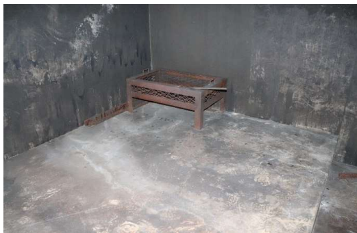
1 階北東燃焼室
