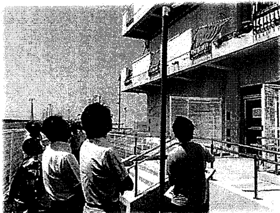
東日本大震災の爪痕が残る校舎
