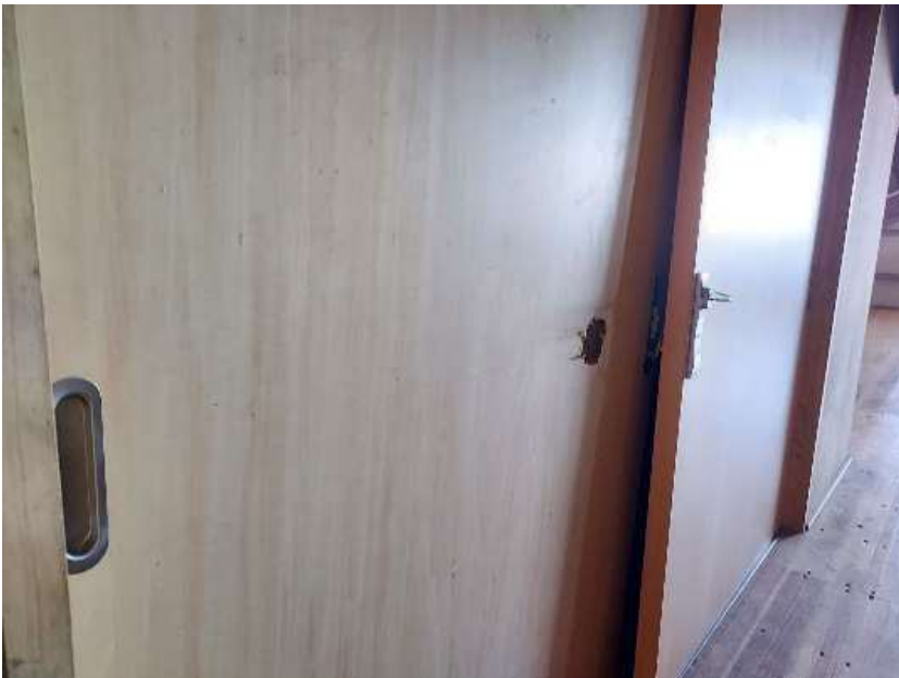
物入 3 被害状況
