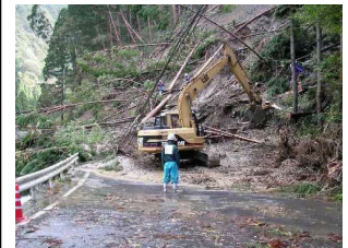
土砂流出による通行止め (H16年10月)
