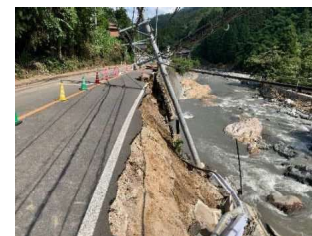
護岸崩壊による通行規制 (R5年8月)
