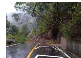
法面崩壊による通行止め (R6年1月)
