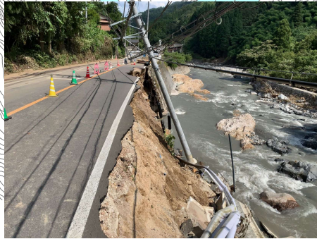
護岸崩壊による通行規制
