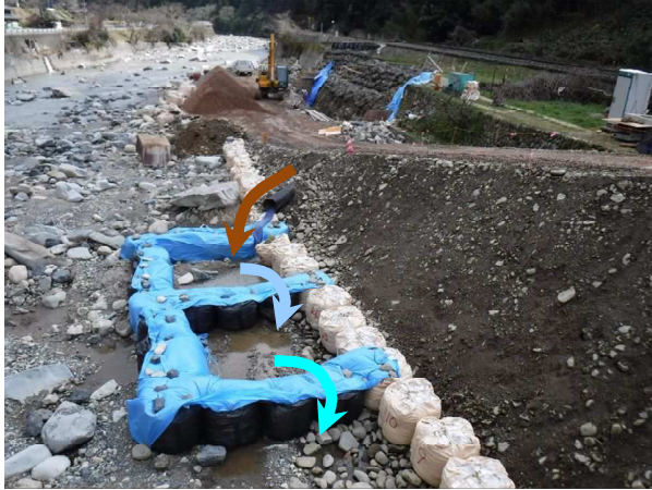
沈砂池による濁水処理
