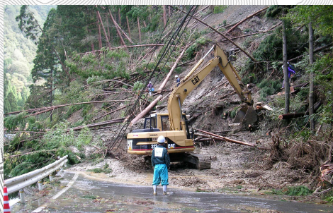
土砂流出による通行止め（H16年10月）
