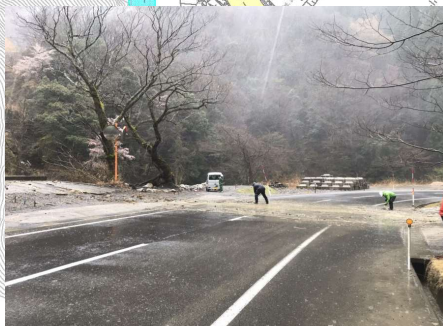
地すべりによる土砂流出による通行止め (R2年4月)
