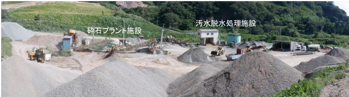
③碎石プラント、脱水処理施設
